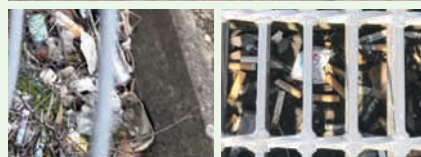
線路沿いフェンス内 フタの中は取りにくい
